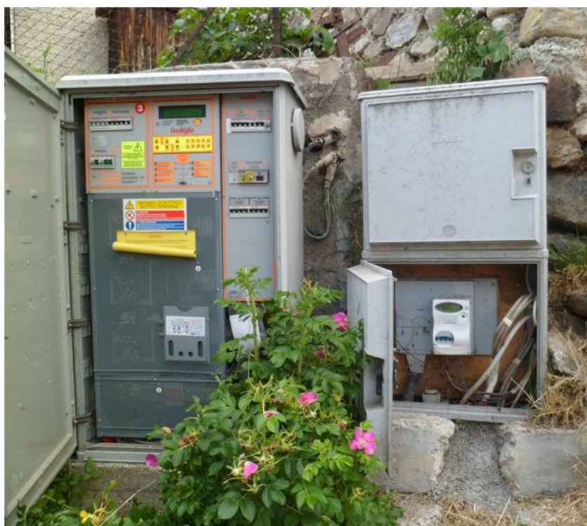
Fig. 17 – Il quadro installato in località Mione
