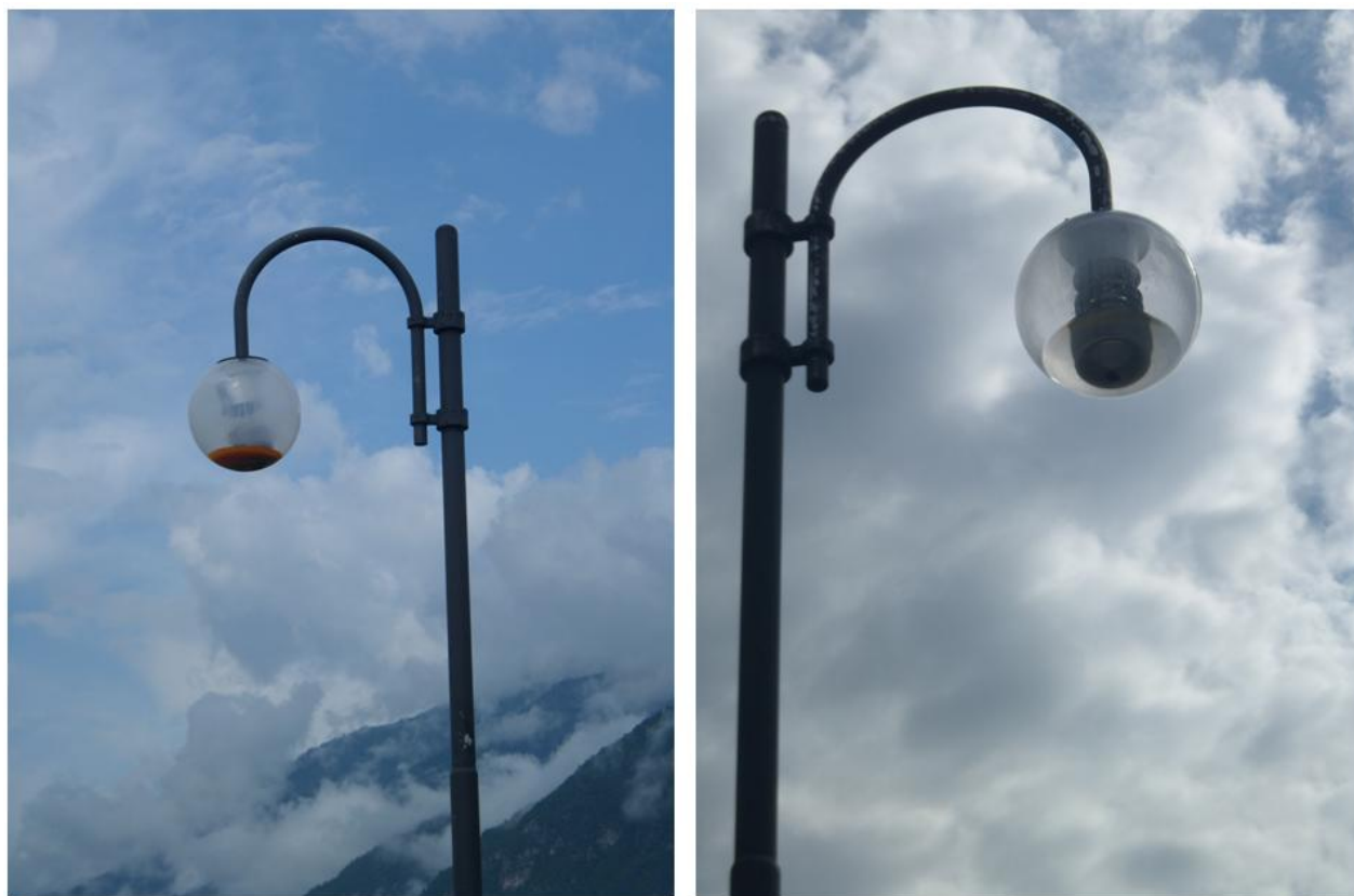
Fig. 22 – Infiltrazioni all'interno dei corpi illuminanti
