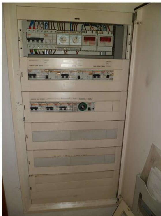
Fig. 13 – Il quadro a servizio del centro dell'abitato di Preghena
