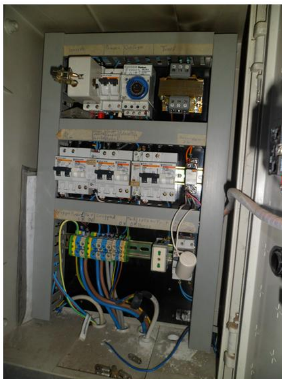
Fig. 12 – Il quadro installato in presso la sede dei VV.FF.
