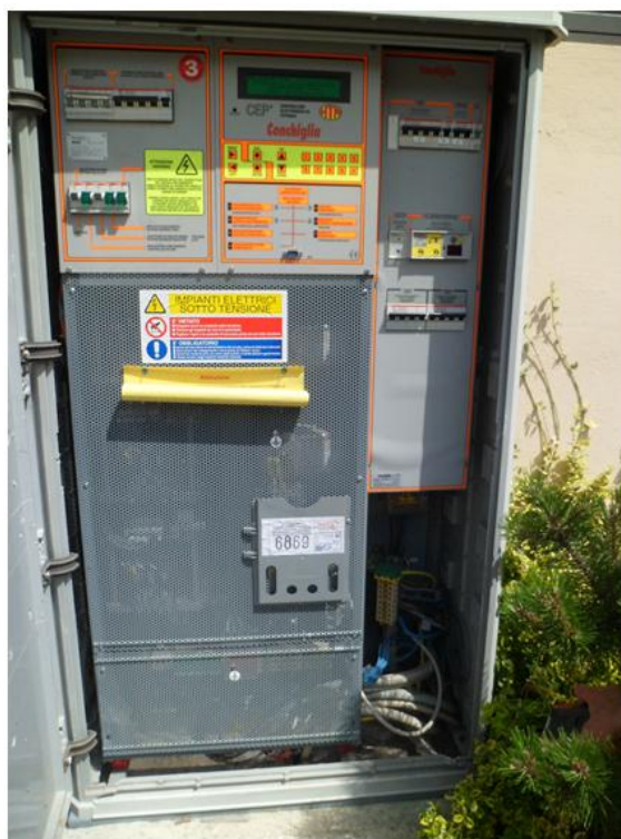
Fig. 16 – Il quadro a servizio dell'abitato di Marcena
