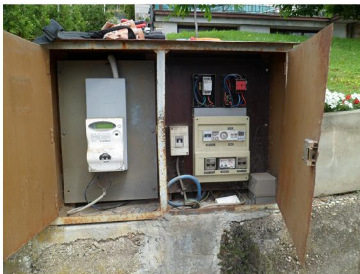
Fig. 14 – Il quadro a servizio della zona più a monte di Preghena
