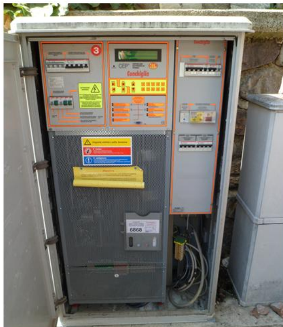
Fig. 18 – Il quadro installato a Corte Inferiore
