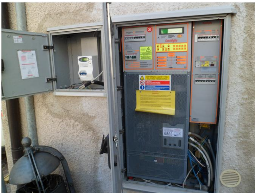
Fig. 20 – Il quadro installato a Lanza
